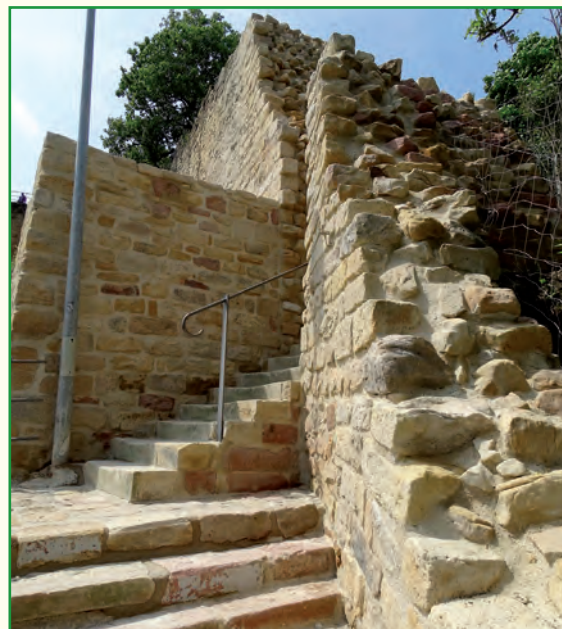
In dieser Ecke der Treppe stand die baufällige Trockenmauer.
